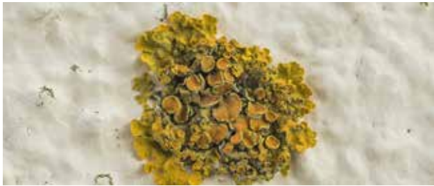
Bild 5: Gelbflechte ( Xanthoria sp.) auf Fassade (Nahaufnahme)
