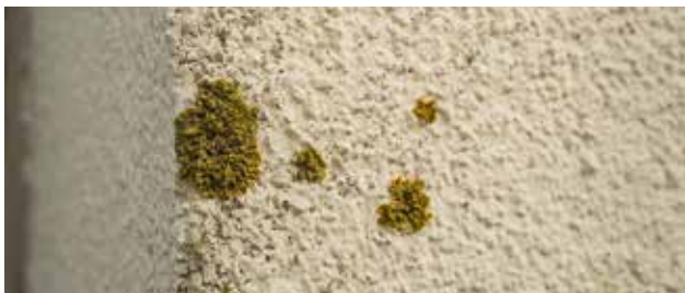
Bild 6: Gelbflechte ( Xanthoria sp.) auf Fassade
